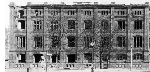
Westseite der kriegsbeschädigten Bauakademie Foto: Dr.-Ing. Helmut Maier
