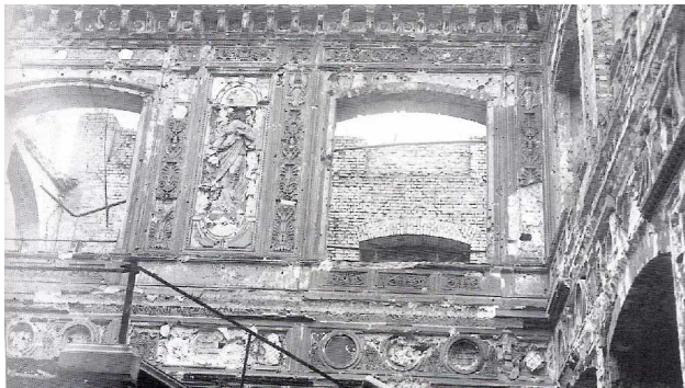
BAUAKADEMIE Zustand von dem Abbruch: Blick in die – später von Richard Lucae – eingefügte Prunktreppe (Abb. aus dem Katalog)
